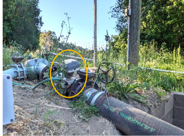
Figura 1. Tubería para agua superficial desviada. El círculo naranja encierra un sensor de agua dentro de la línea y un medidor de datos.
